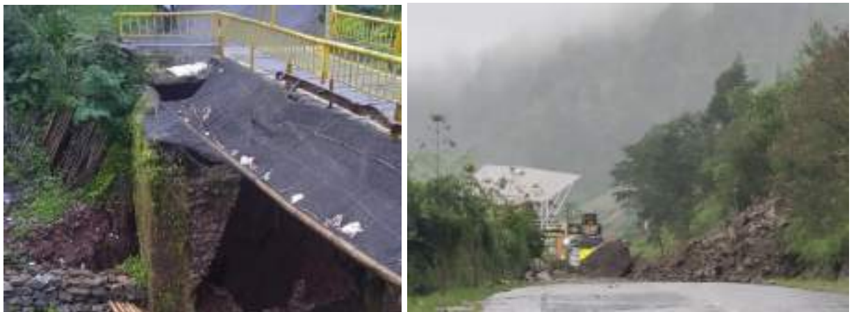
Gambar 61. Peristiwa longsor pada akhir tahun 2023 di Kabupaten Karanganyar
