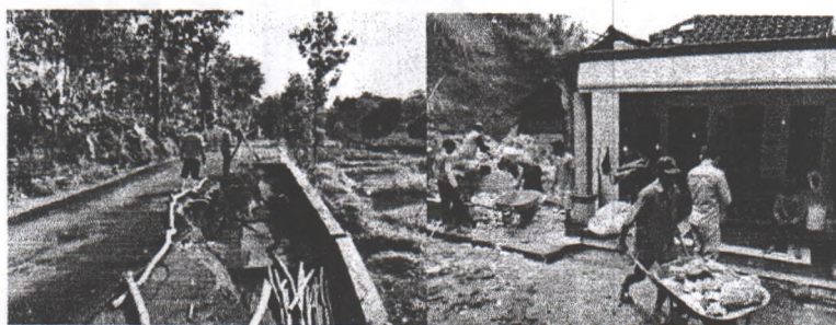
Gambar III.5. Peristiwa longsor pada akhir tahun 2020 di Kabupaten Karanganyar
