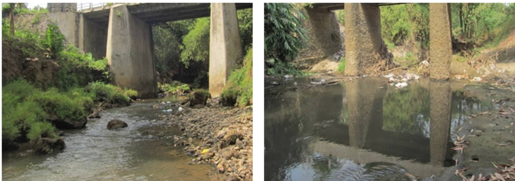
Gambar 57. Dokumentasi kondisi Sungai Sroyo bagian hulu (kiri) dan hilir (kanan)
