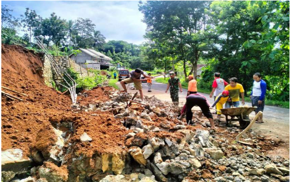
Melakukan Cek Lokasi Bencana Tanah Longsor/Talud Ambrol SD MPU JATIPURO
